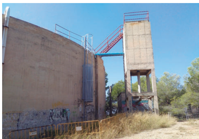
L'equipament està molt malmès (Foto: A. Fusté -Aj. de Torredembarra)
